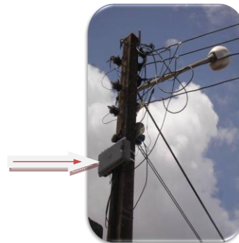
Figura 5. Protótipo instalado no poste da rede de distribuição para atendimento de duas UC monofásicas
